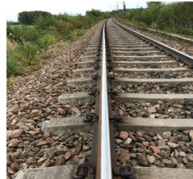
Skadad spårkomponent och försämrat spåräge
